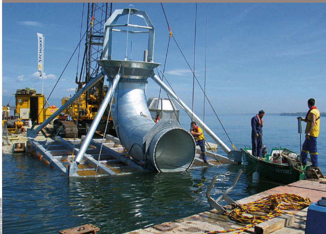
La crépine d'aspiration est posée à 40 mètres de profondeur dans le lac Léman
