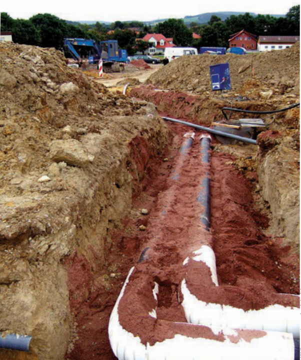
Jühnde, premier village totalement alimenté en chauffage par deux sources : le biogaz et le bois
