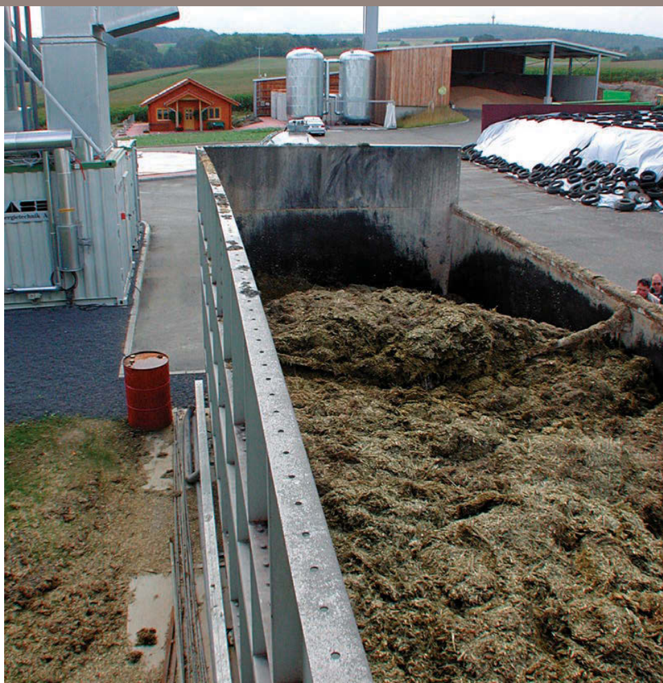
Au premier plan, de la biomasse agricole, au fond, le brûleur d'appoint au bois
